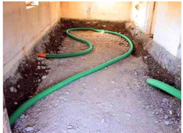
Flächige Absaugung (Radondrainage). Bei Erneuerung des Fussbodenunterbaues werden nach Aushub (ca. 40 cm tief) Drainagerohre mit einem Durchmesser von 10 cm unter den Rohbeton in das Kiesbett eingelegt. Das Drainagesystem wird so verlegt, dass eine flächenhafte Absaugung gewährleistet ist. Die Abluftleitung muss als Vollwandrohr ausgeführt sein.
